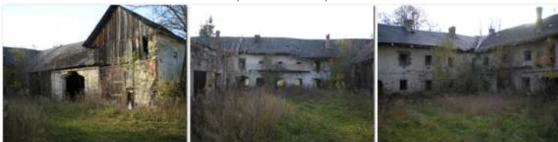
Zpustošená vnitřní část budovy bývalé STS, kde poté bývala opravárenská dílna statků až do roku 1976
