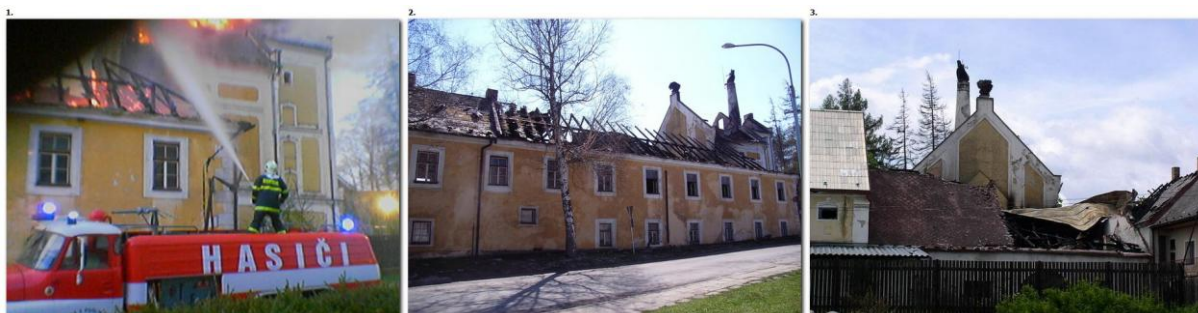
V květnu 2006 část budovy vyhořela
